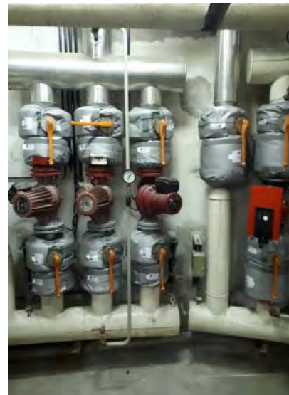
Panoplie en chaufferie
